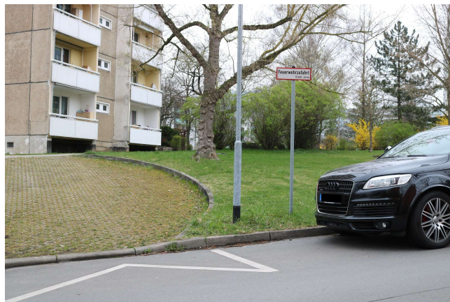
Abb. 21 – Deutliche Bordsteinabsenkung im Bereich einer Feuerwehrezufahrt [c]
